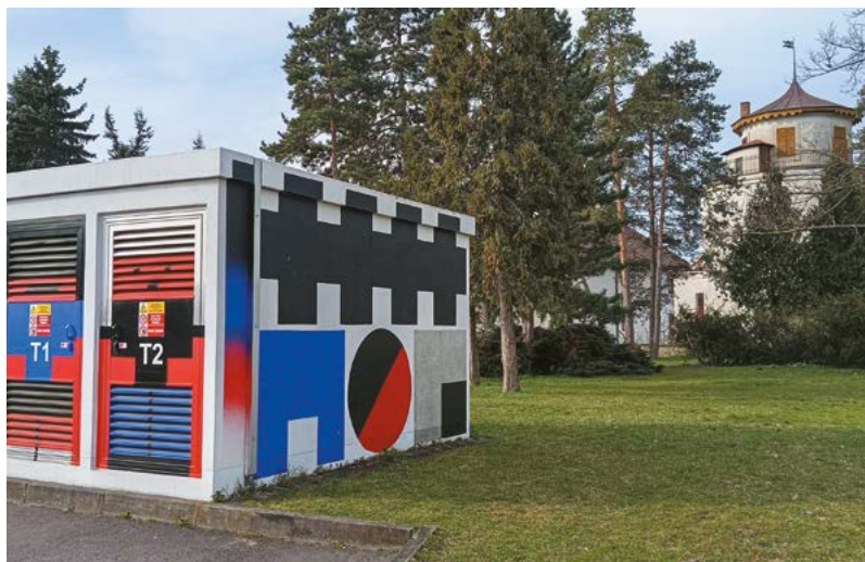
Tlustá věž s výtvarně pojatou trafostanicí
